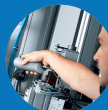
Detección de Fugas en Línea
