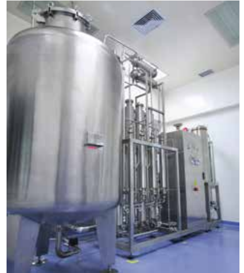
Medición de flujo de agua desmineralizada
