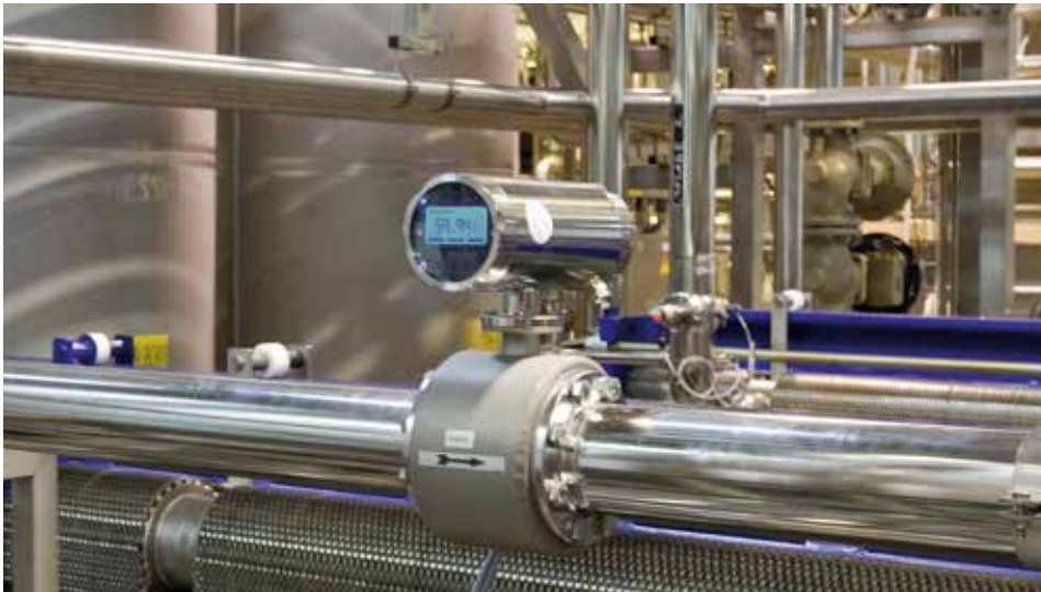
Medición de flujo rapido en pasteurizador
